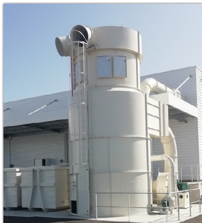
Cyclofiltre 4X7 avec débit d'air de 31 000 m 3 / h pour aspirer les poussières de bois sur quatre centres d'usinage.
