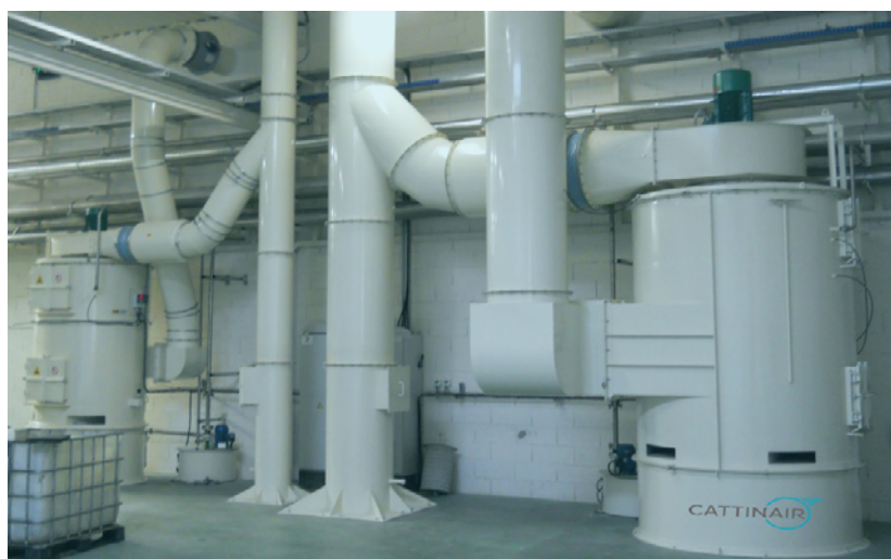
Application sur huiles entières et solubles avec filtres Mistral NOMF 2 et NOMF 8 et ventilateur intégré dans un process d'usinage moyeu avec un débit de 5 000 et 20 000 m 3 /h.
