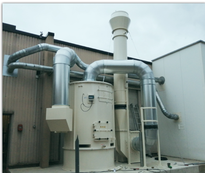
Intégration d'une filtre Mistral NOMF 6 pour aspirer les machines d'un atelier fer chez un fabricant de couteaux.
